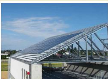
太陽光パネル
